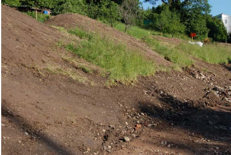
Abb. 7: Reste des im Zuge der Baumaßnahmen stark in Mitleidenschaft gezogenen Trockenrasens.
